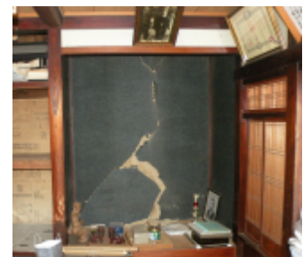
地震で損傷した土壁の例
