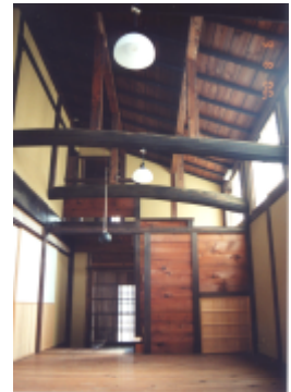
会場の土壁の町家 (日本で初めて実験で防火・耐震改修の有効性を検証した町家)
